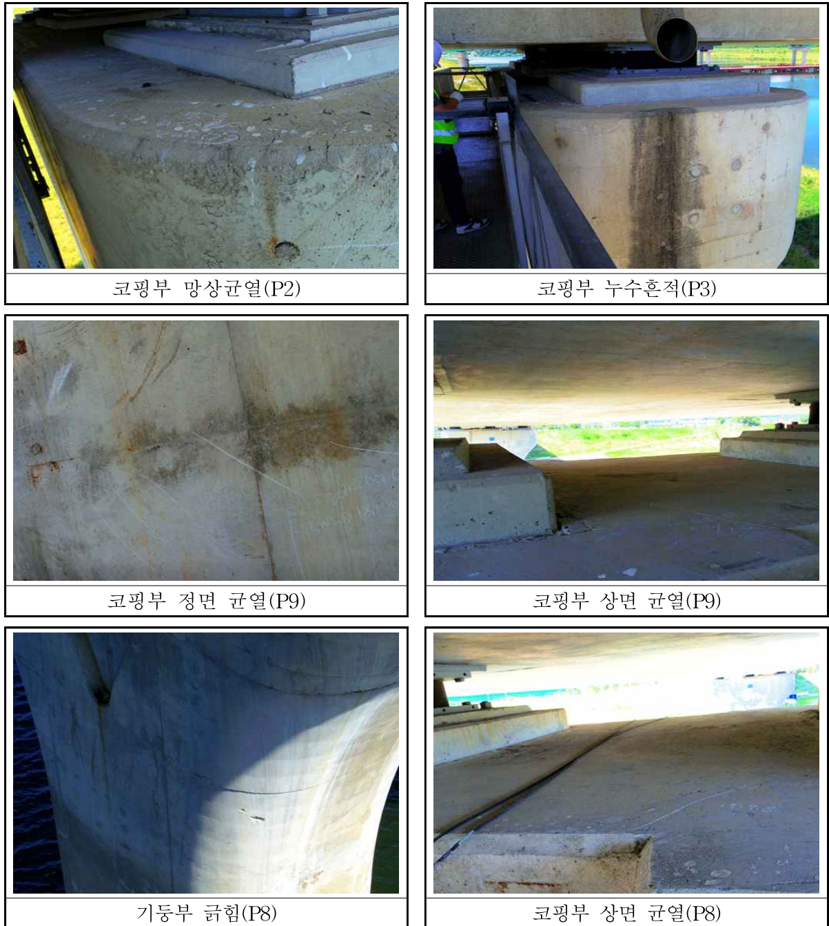
【그림 3.18】 교각 손상 현황
