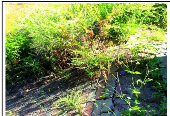
교대 보호블럭 파손(A1)
