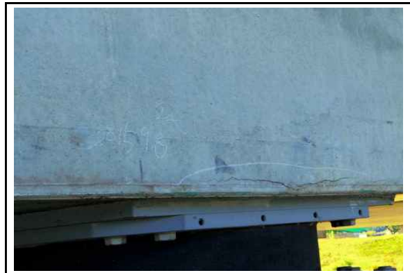
거더 외부 하면 들뜸(S8)
