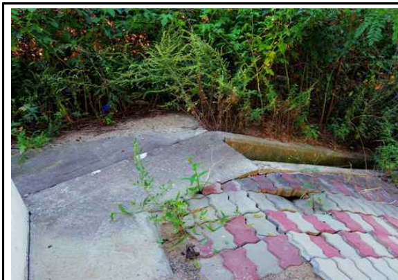
교대 보호블럭 파손(A1)
