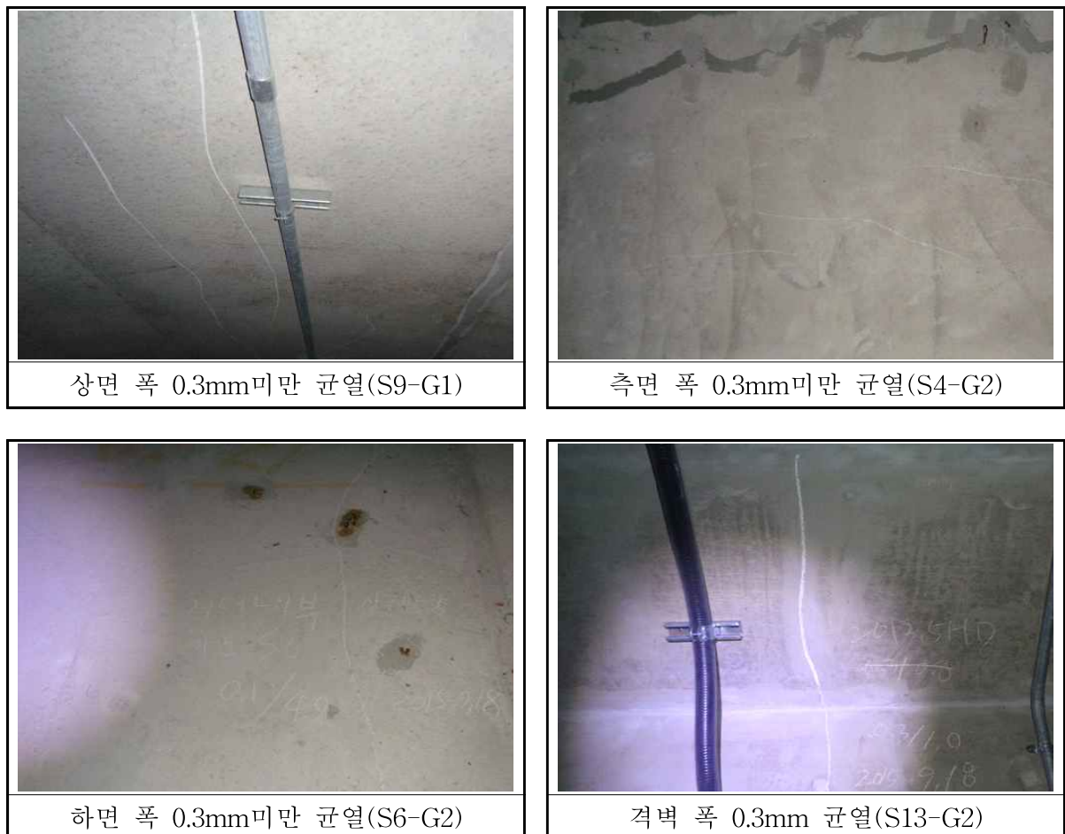
【그림 3.11】 거더 내부 손상 현황
