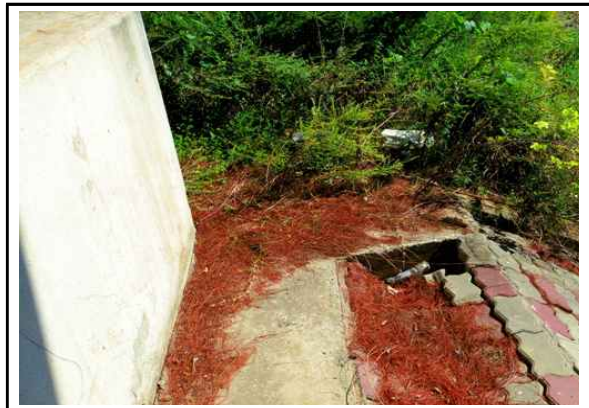
교대 보호블럭 파손(A2)
