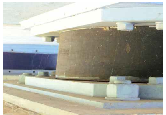
본체 고무재 들뜸(P10-SH2)
