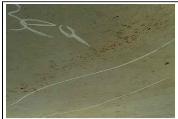
거더 외부 하면 균열(S11)
