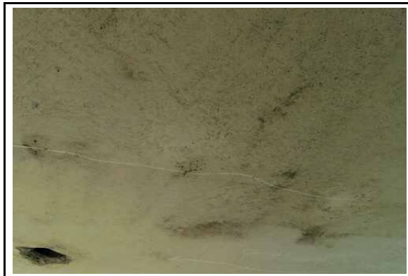
거더 외부 하면 균열(S3)
